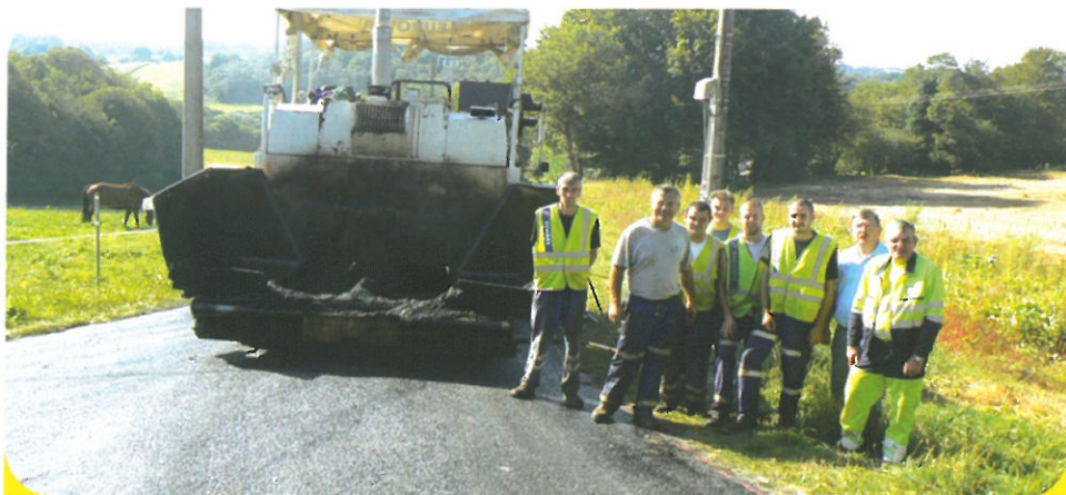
Travaux d'enrobage effectués par l'entreprise Eurovia, en présence des représentants de la mairie (ici à Trevenen)
